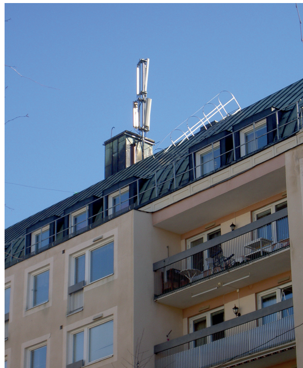
Exempel på antenner till en basstation för mobiltelefoni.
